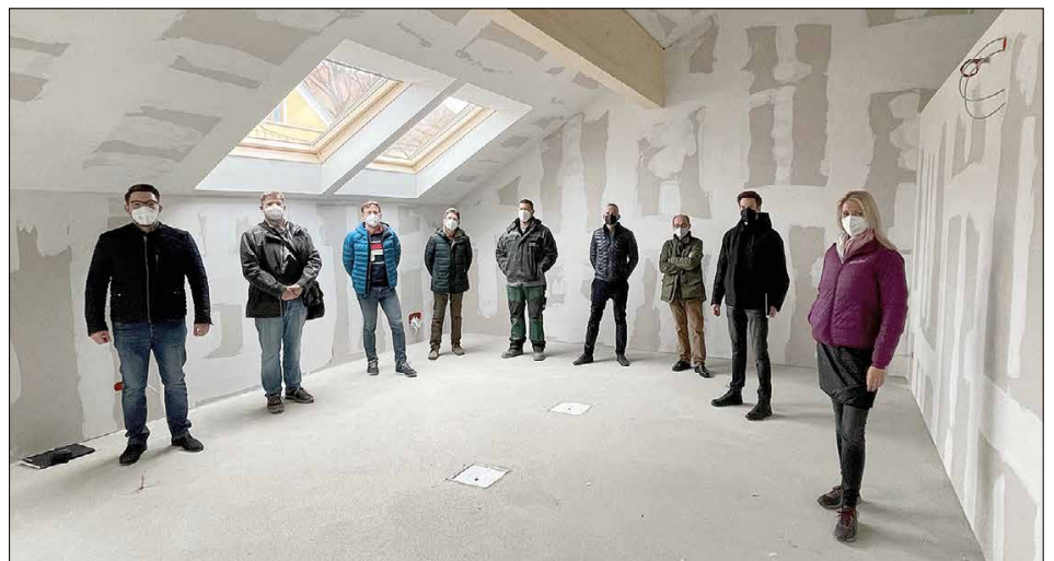
Jede Woche findet in der Schule die oft stundenlange Baubesprechung mit den Planern, der Bauaufsicht, der Gemeinde und bauausführenden Firmen statt.
