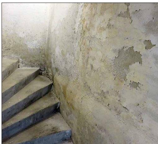
Die Wände – vor allem im Keller – sind feucht und damit auch schimmelfähig.
