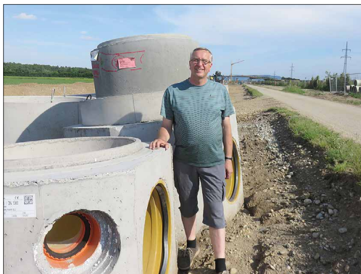
Vizebürgermeister Karl Scherz: Entlang der Bahntrasse wurde auch der Koralmwasser vom Abwasserverband verlegt.
