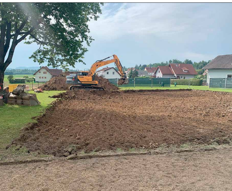
Die Baustelleneinrichtung erfolgte am 18. Mai. Mit den Aushubarbeiten wurde am 19. Mai begonnen.
