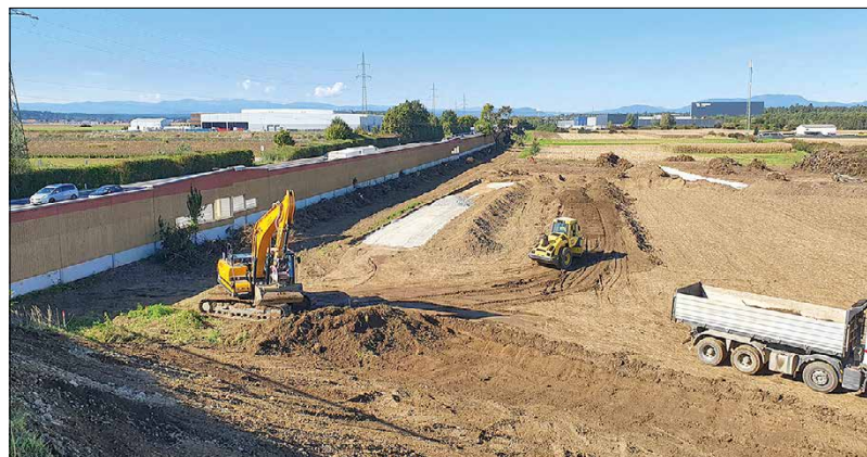
Auch im Bereich der Werndorfer Brücke wurde bereits mit den Arbeiten begonnen. Neben der bestehenden Brücke wird die neue Brücke errichtet. Die alte Brücke wird danach abgerissen.
