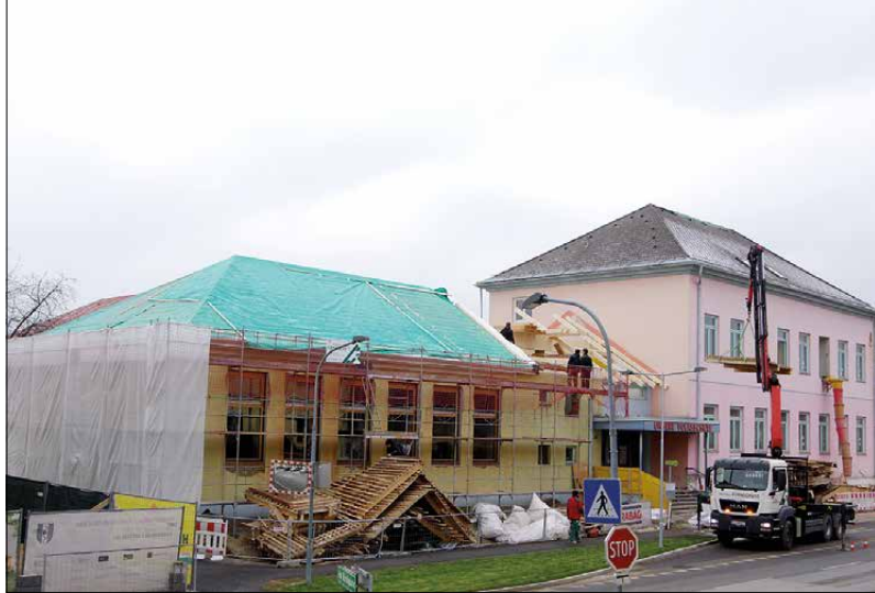
Das Turnsaal-Dach wird neu eingedeckt und der Bereich über dem Konferenzzimmer bekommt einen komplett neuen Dachstuhl.
