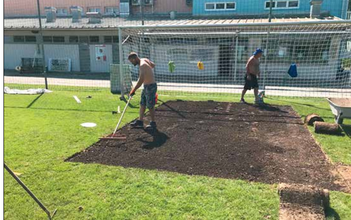
Der Rasen im Bereich der Tore wurde Ende Juni vom Vorstand und von unserem Platzwart Wolfgang Steinacher saniert.
