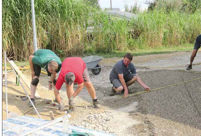
Der Platz zwischen der ESV-Halle und dem Beachvolleyballplatz wurde von den ESV-Mitgliedern neu gepflastert und wurde rechtzeitig zur Eröffnung des Beachvolleyballplatzes fertig.
