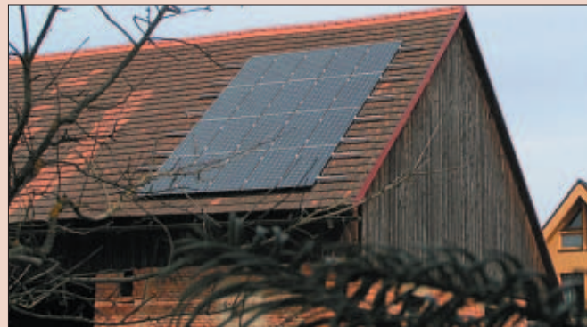
Die Familie Rabold in Gradenfeld zeigt vor, wohin in Zukunft der Weg gehen soll und errichtete auf ihrem Nebengebäude eine Photovoltaikanlage.
