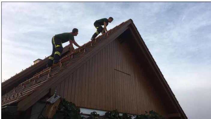
Nach dem Gewittersturm am 18. August mussten einige Dächer im Gemeindegebiet repariert werden.
