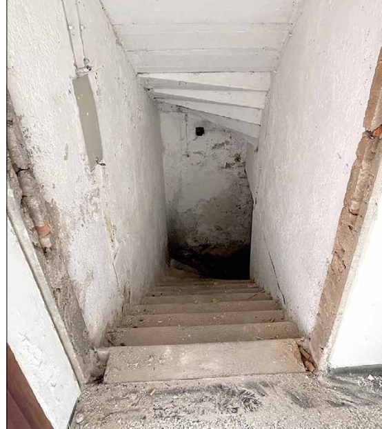
Der Blick in den Keller zeigt, dass das Mauerwerk feucht und schimmelig ist. Eine sinnvolle Sanierung des Mauerwerks wäre unmöglich.
